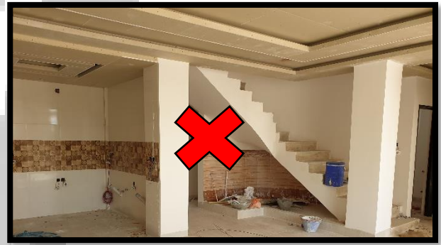
عدم نصب نرده در راه پله
