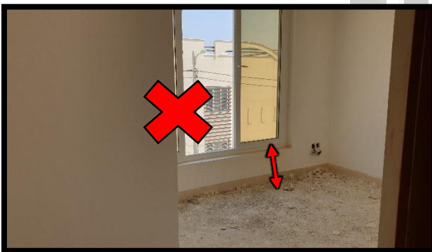
عدم اجرای حداقل OKB در طبقات بالای همکف مشرف به پلاک های مجاور
