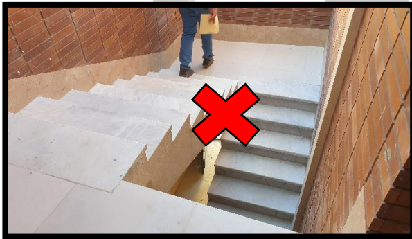
عدم نصب نرده در راه پله
