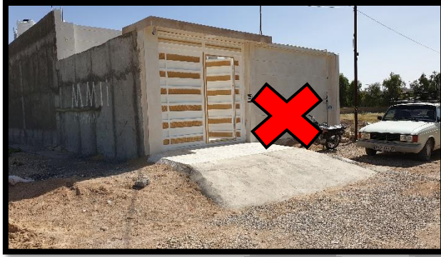
اجرای غیر اصولی رمپ در معبر عمومی (عدم اجرای صحیح بر و کف)
