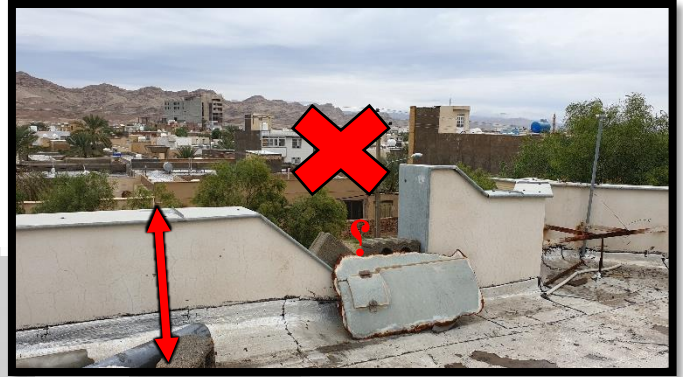
عدم اجرای صحیح جان پناه و عدم رعایت حداقل ارتفاع
